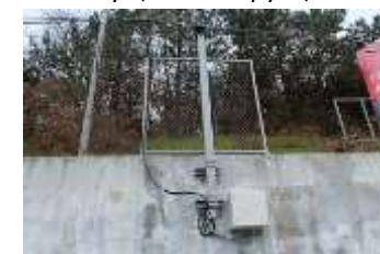
Оборудование для контроля смещения откосов на подходах к мосту
