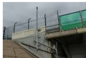
Оборудование для контроля смещения береговых опор моста
